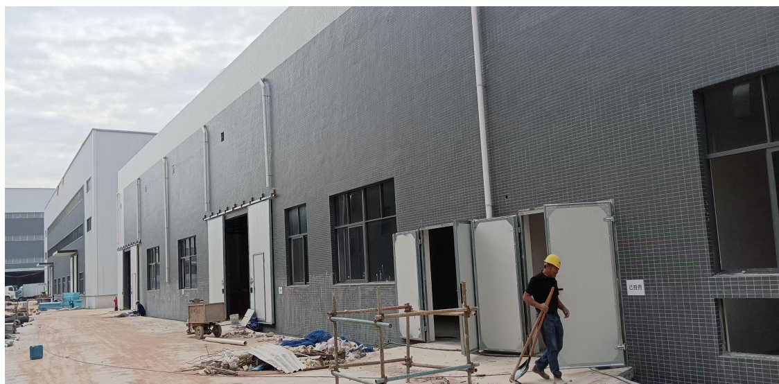
图 1 BOPP 薄膜及特种胶带生产项目- BOPP 薄膜车间
