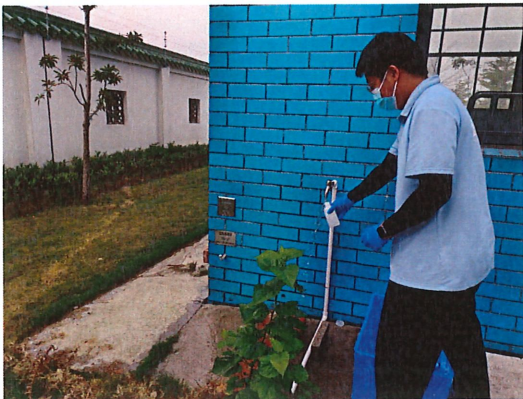
第三水厂出厂水采样口
