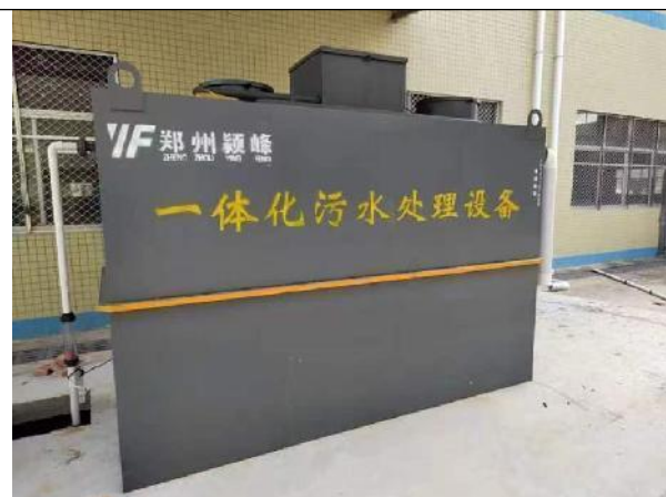
室外一体化治理设施
